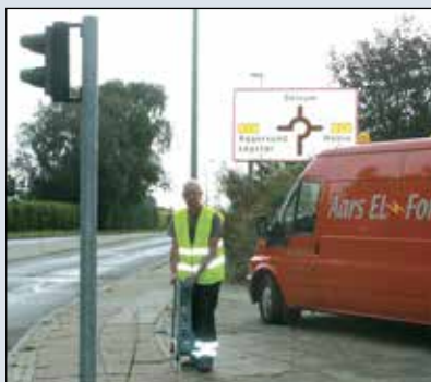
Elektriker Kaj Grøn, Aars El-Forsyning Entreprise A/S, er her i gang med at fejlsøge for spolefejl ved Oustrupvej-krydset i Aars. Via spolerne styres trafiklyset.
